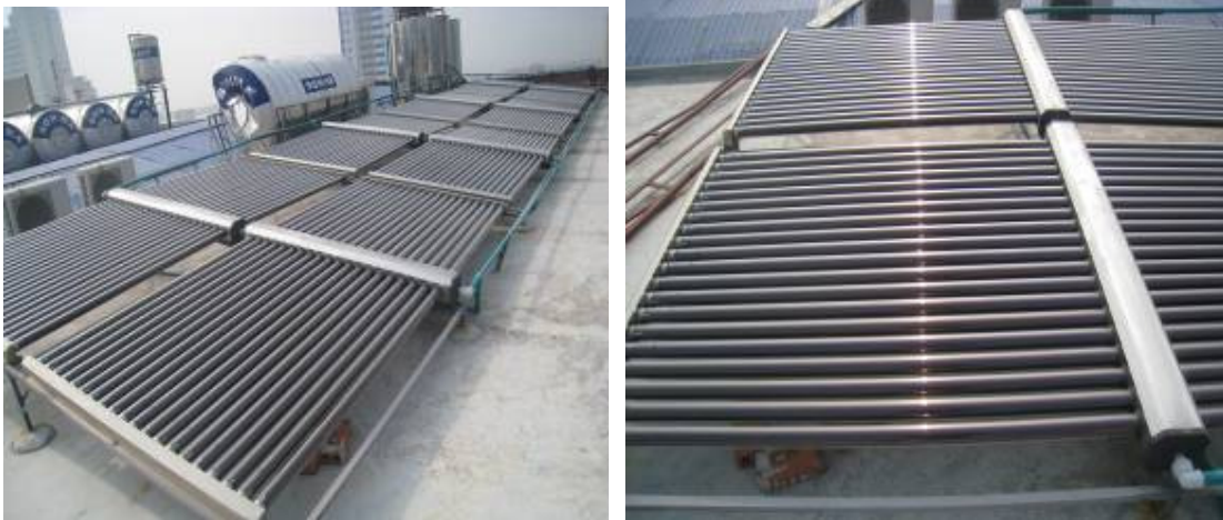
Hình ảnh dàn nước nóng năng lượng mặt trời được lắp đặt tại khách sạn
