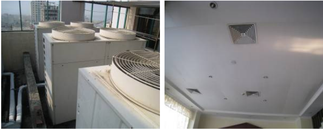
Hình ảnh giàn nóng và giàn lạnh của hệ thống điều hòa VRV
